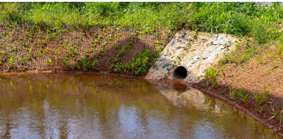
Bassin de récupération d'eau de pluie
